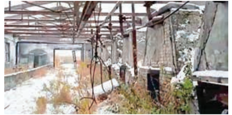
От котельной остались руины.
